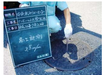
マンホール蓋凹部3.5mm
