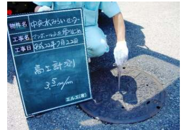
マンホール蓋凹部3.5mm
